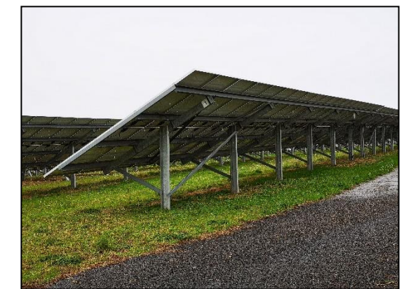
Reprise végétale sous les panneaux photovoltaïques
